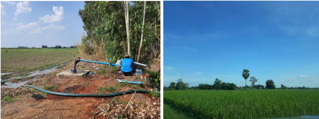
การใช้พลังงานแสงอาทิตย์ในการสูบน้ำเข้านาดำเชื้อเพลิงในการสูบน้ำเข้านาของตำบลหนองหลวง
