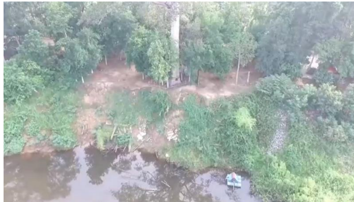
รูปที่ 4-3 ฝายแกนดินซีเมนต์บ้านกุดหล่ม ต.ศรีบุญเรือง อ.ชนบท จ.ขอนแก่น ที่มา : คณะกรรมการการแก้ปัญหาความยากจนและลดความเหลื่อมล้ำ วุฒิสภา
