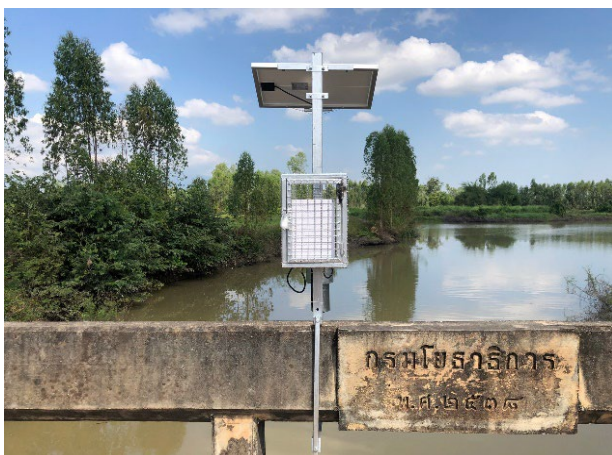
รูปที่ 4 ระบบติดตามระดับน้ำในคลองส่งน้ำสายหลักและสายซอย
