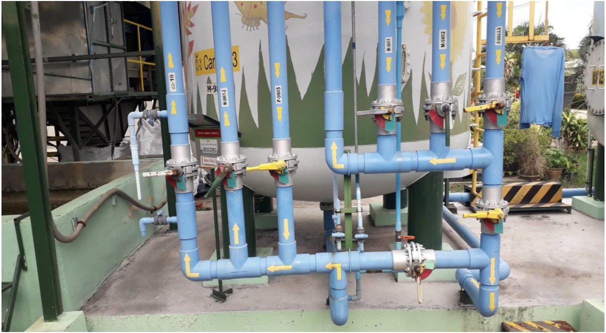
รูปที่ 3-52 ขั้นตอนการทำระบบ Automation back wash ของบริษัท ไทย เอ็มเอพีซี จำกัด
