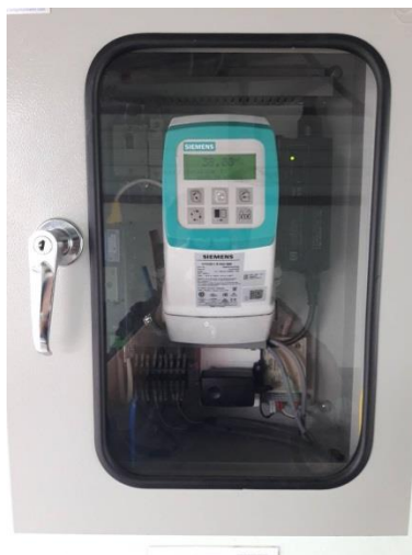
รูปที่ 3-103 IoT - Flow meter ที่ท่อน้ำเสียออกจากบ่อดักไขมันของ บริษัท ไทยเพรซิเดนท์ฟูดส์ จำกัด (มหาชน)
