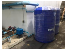
จุดถังเก็บน้ำทิ้งหลังบำบัด
