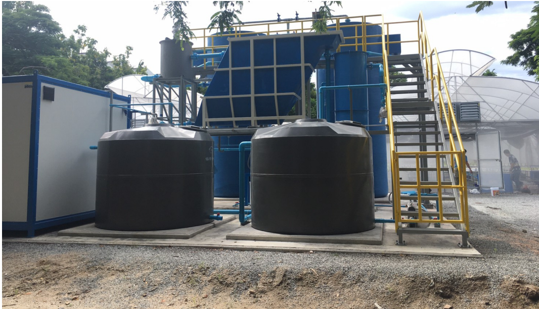
รูปที่ 4.5-2 อาคารระบบบำบัดน้ำเพื่อนำกลับมาใช้ใหม่
