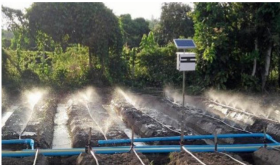
รูปที่ 3.1-1 ระบบการให้น้ำแบบพ่นน้ำพุ่ง ควบคุมด้วยเซ็นเซอร์ตรวจวัดความชื้น
