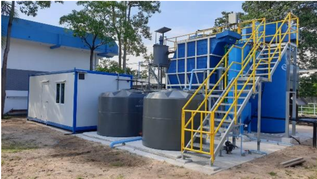
ภาพที่ 2.2-1 ระบบบำบัดน้ำเสียแบบ MBBR ณ โรงเรียนปรับปรุงคุณภาพน้ำแสนสุข (เหนือ)
