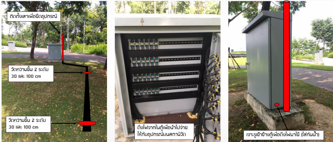
รูปที่ 4.1-2 ตำแหน่งติดตั้งอุปกรณ์ตรวจจับที่เชื่อมกับระบบไฟฟ้าของสวนฯ 100 ปีฯ
