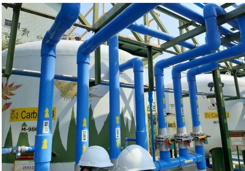
รูปที่ 4.10 ถังกรองคาร์บอน
