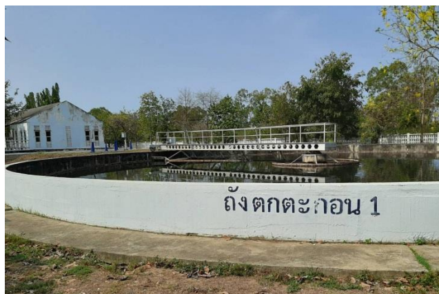
รูปที่ 2.86 ถังตกตะกอน
