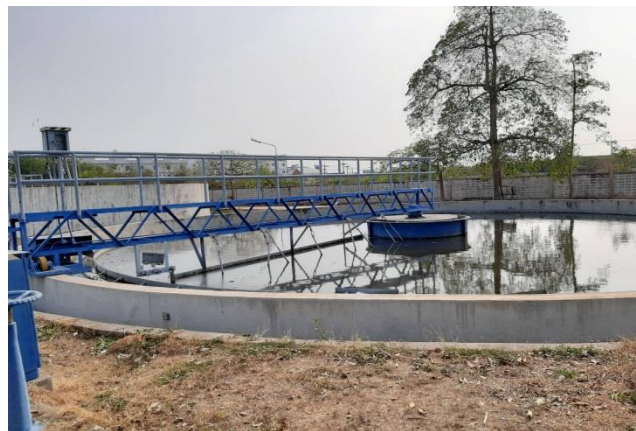
รูปที่ 2.54 ถังตกตะกอน
