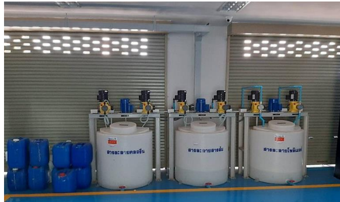
รูปที่ 2.68 ถังเติมสารเคมี
