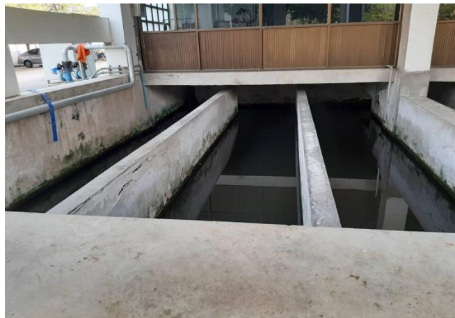
รูปที่ 2.28 บ่อพักน้ำทิ้งหลังการบำบัด
