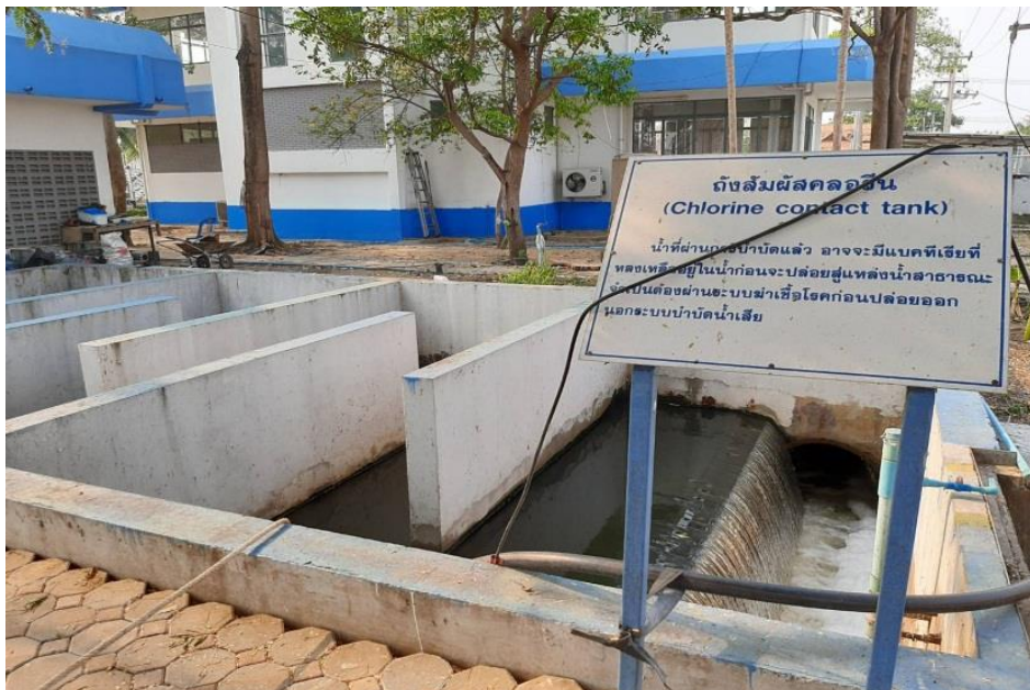
รูปที่ 2.56 บ่อพักน้ำหลังการบำบัด (เดิมเป็นบ่อเติมคลอรีน)
