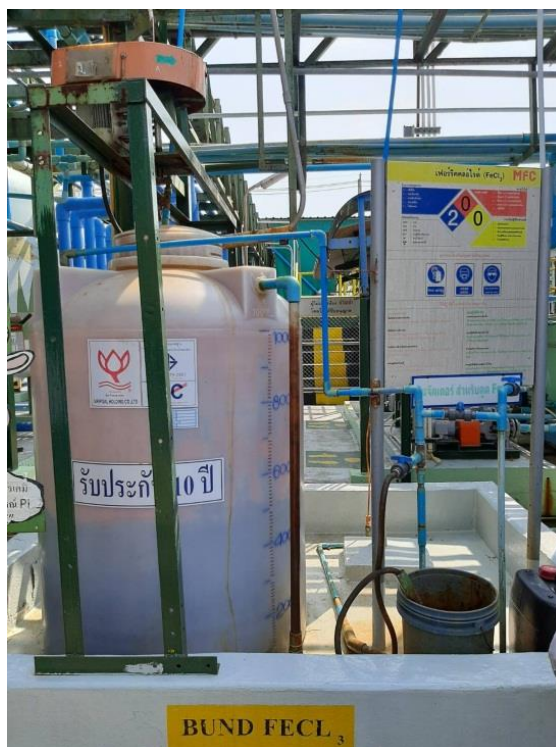
รูปที่ 4.9 ถังสารเคมี FeCl 3
