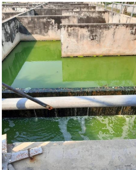
รูปที่ 2.21 บ่อพักน้ำหลังการบำบัด
