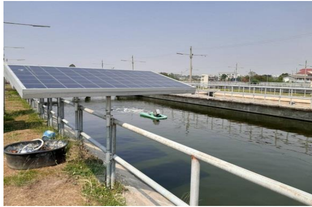
รูปที่ 2.19 เครื่องเติมอากาศแบบใช้โซลาร์เซลล์ในระบบคลองวนเวียน
