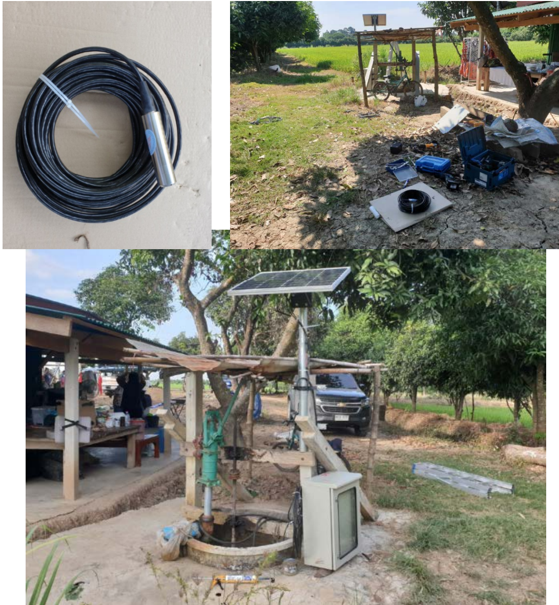
รูปที่ 5.2-16 สถานีวัดที่ 1 ฐานรองรับชุดเครื่องมือกับบ่อน้ำต้นสังกัดการณ์ และติดตั้งตู้ควบคุมบ่อน้ำพร้อมประกอบอุปกรณ์ระบบเซนเซอร์ ชุดควบคุม ชุดแหล่งจ่ายไฟฟ้าสำหรับจ่ายพลังงานให้กับชุดเซนเซอร์ และชุดแผงโซลาเซลล์บนเสาเหล็กกล้าวาไนซ์
