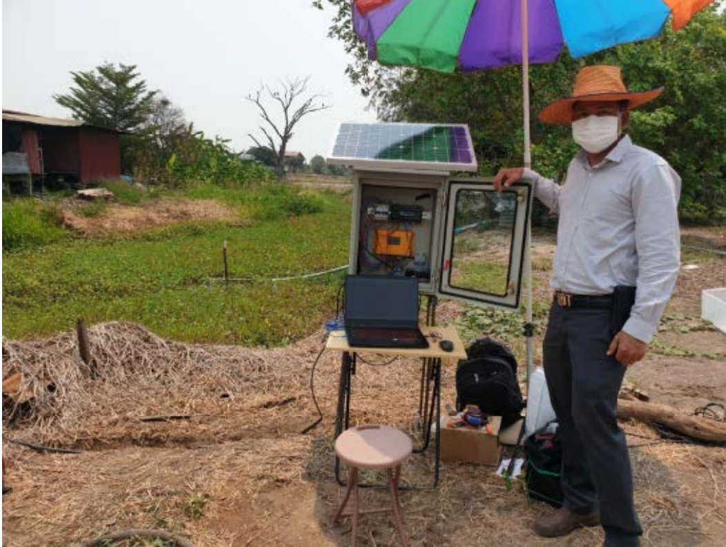
รูปที่ 5.2-22 สถานีวัดที่ 4 ฐานรองรับชุดเครื่องมือกับบ่อน้ำต้นสังเกตการณ์ และติดตั้งตู้ควบคุมบนบ่อพร้อมประกอบอุปกรณ์ระบบเซนเซอร์ ชุดควบคุม ชุดแหล่งจ่ายไฟฟ้าสำหรับจ่ายพลังงานให้กับชุดเซนเซอร์ และชุดแผงโซลาเซลล์
