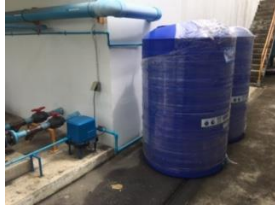
จุดถังเก็บน้ำทิ้งหลังบำบัด
