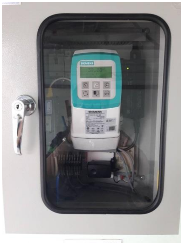
รูปที่ 4.50 IoT - Flow meter ที่ท่อน้ำเสียจากบ่อดักไขมันของบริษัท ไทยเพอร์ซิเดนท์ฟูดส์ จำกัด (มหาชน) ภายใต้การดำเนินโครงการ
