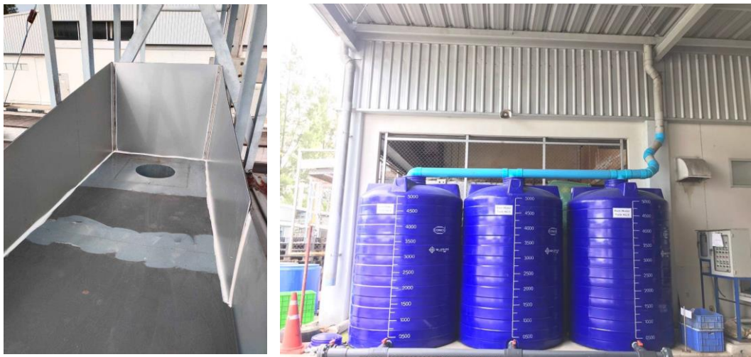
รูปที่ 4.21 ระบบกักเก็บน้ำฝนของบริษัท ไทยนิปอนรับเบอร์ อินดัสตรี จำกัด (มหาชน)
