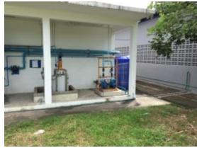
จุดปล่อยน้ำทิ้งหลังบำบัด
